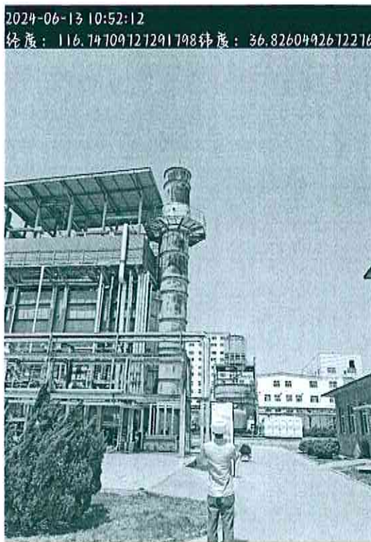
4#燃气轮机组排气筒 (DA019)
